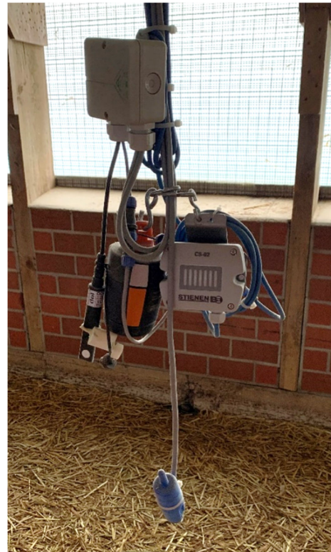
Abb. 15: Messtechnik zur kontinuierlichen Erfassung der Klimadaten auf dem (Fokus-) Betrieb A (Temp., rel. LF, CO 2 , NH 3 )
