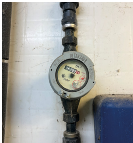
Abbildung 60, Folie 53: Durch die Installation von Wasseruhren vor den Abteilen, können Veränderungen im Wasserverbrauch erkannt werden (© L. Schönberg)
